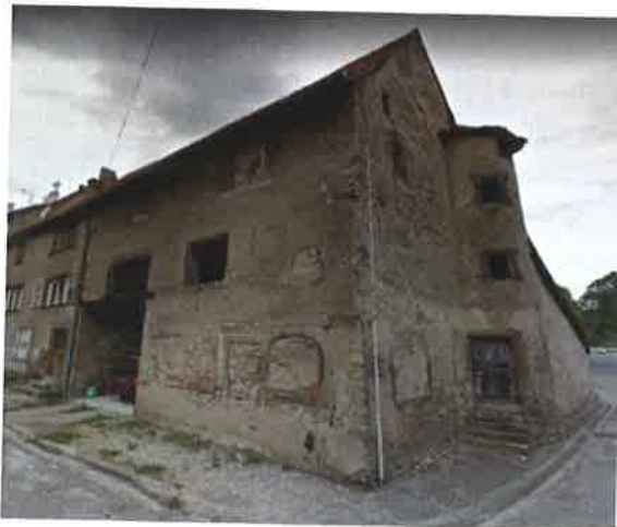
Magasin médiéval avant rénovation, en péril imminent.
